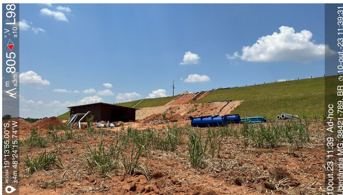
Figura 7.15 Casa de bombas do piscinão
