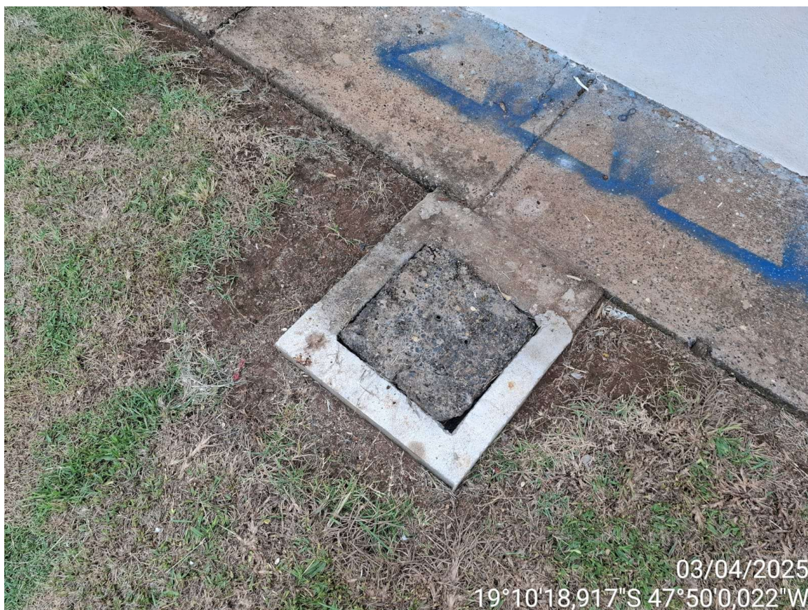
Imagem 9: Caixa de gordura.
