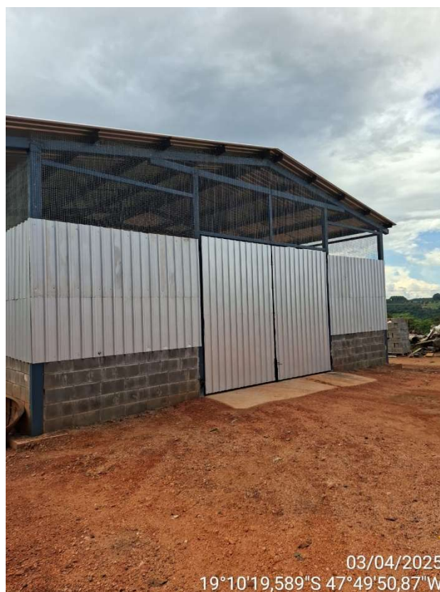
Imagem 20: Galpão para armazenamento de embalagens vazias de defensivos agrícolas.
