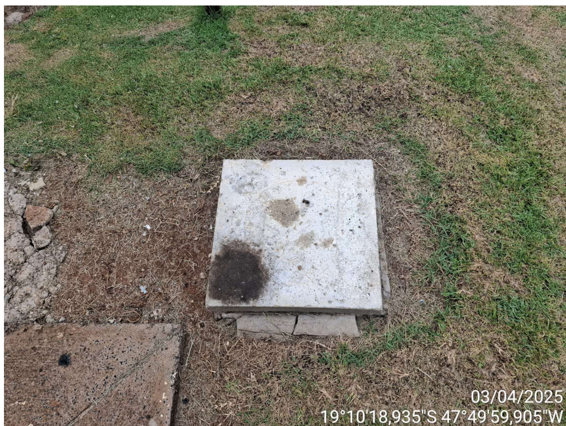
Imagem 8: Caixa de gordura.
