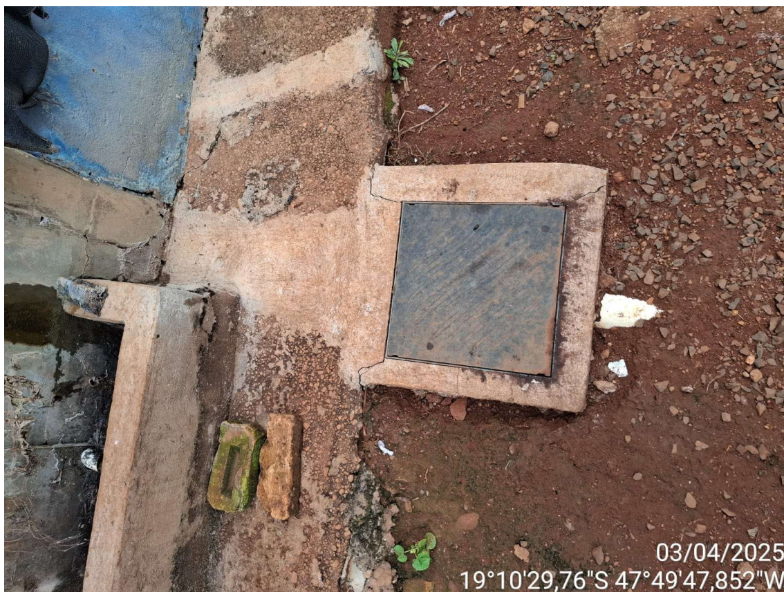
Imagem 11: Caixa de gordura.
